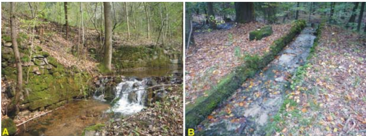
Fot. 24. Zniszczona XIX-wieczna zabudowa oporowa w korytach potoków Gór Stołowych: A – Kudowski Potok, B – Rogoziniec (fot. M. Witek).
